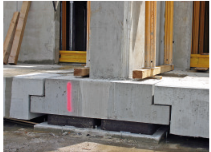
Bild 7. Lagersockel mit Elastomer-Einzellager zur Lastweiterleitung in das Tiefbauwerk Fig. 7. Bearing with elastomeric springs for load transfer in underground structure
